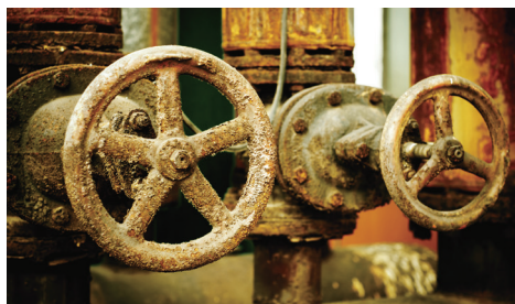
图1-4-1 常见的金属腐蚀现象
